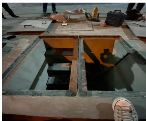
cajas de inspección
